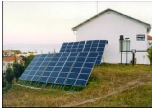
Resim 1.6: Güneş enerjisi kolektörleri
